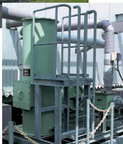
筑波研究所 固液分離槽脱臭設備
