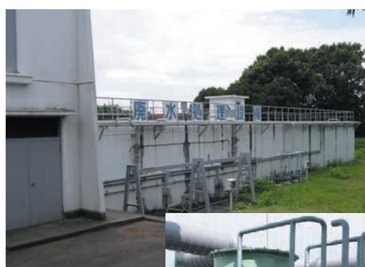
フジヤマ工場廃水処理設備
