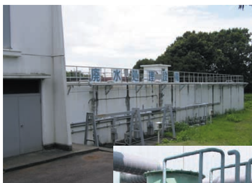
フジヤマ工場廃水処理設備
