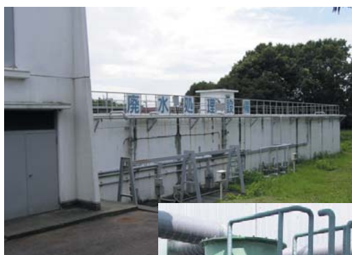
フジヤマ工場廃水処理設備
