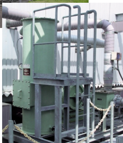
筑波研究所 固液分離槽脱臭設備
