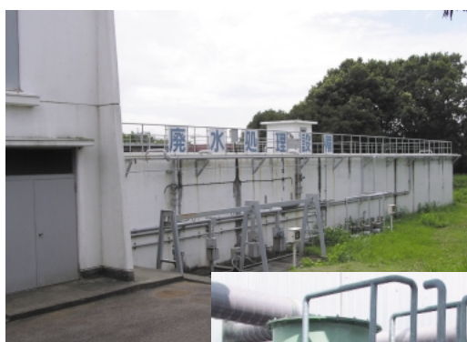
フジヤマ工場廃水処理設備
