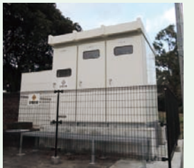
フジヤマ工場 キュービクル
