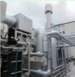
CGSから排出される排ガス処理装置
