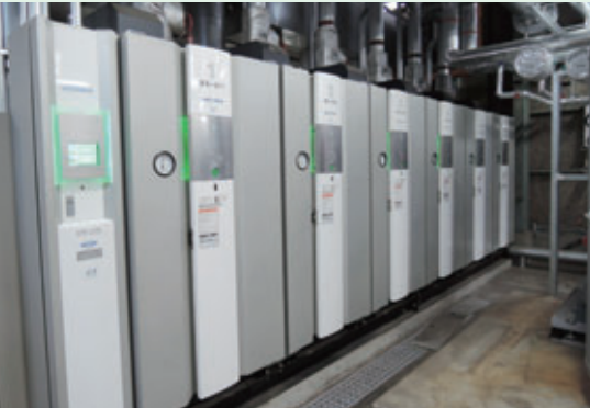
フジヤマ工場 ボイラー設備
