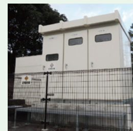
フジヤマ工場 キュービクル
