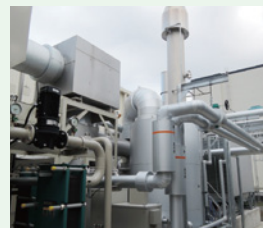
CGSから排出される 排ガス処理装置
