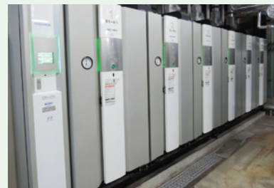
フジヤマ工場 ボイラー設備
