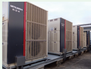
水無瀬研究所 ヒートポンプチャラー
