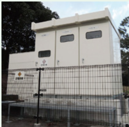
フジヤマ工場 キュービクル
