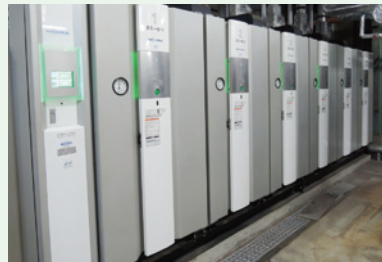
フジヤマ工場 ボイラー設備
