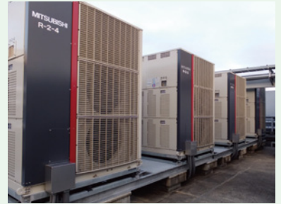
水無瀬研究所 ヒートポンプチラー
