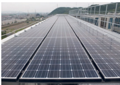
水無瀬研究所 太陽光発電パネル
