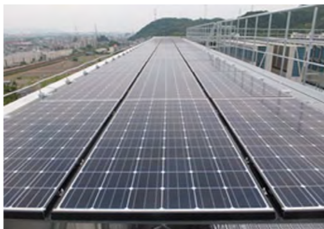
水無瀬研究所 太陽光発電パネル
