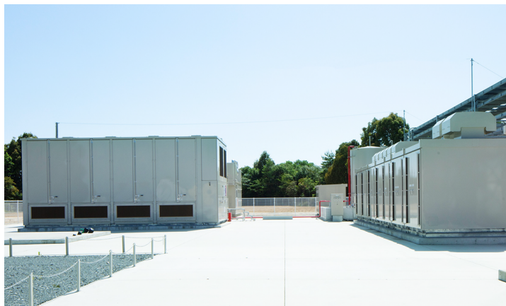
大容量蓄電システム（山口工場）
