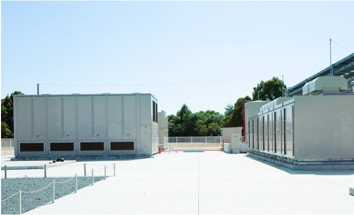
大容量蓄電システム（山口工場）
