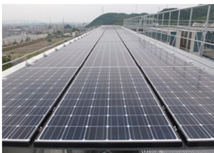
水無瀬研究所 太陽光発電パネル
