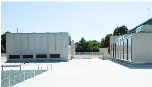
大容量蓄電システム（山口工場）
