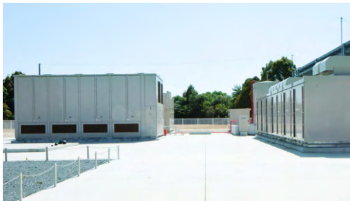
大容量蓄電システム（山口工場）
