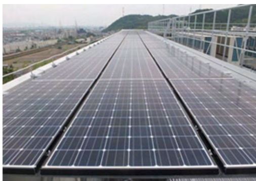
太陽光発電パネル（水無瀬研究所）
