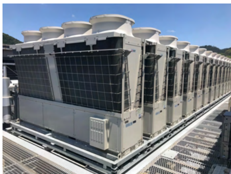
モジュールタイプヒートポンプチラー（水無瀬研究所）
