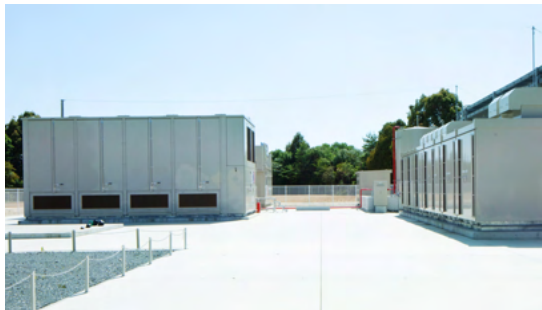
大容量蓄電システム（山口工場）
