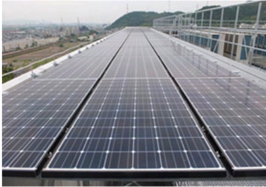
太陽光発電パネル（水無瀬研究所）
