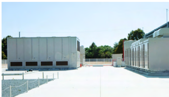
大容量蓄電システム（山口工場）
